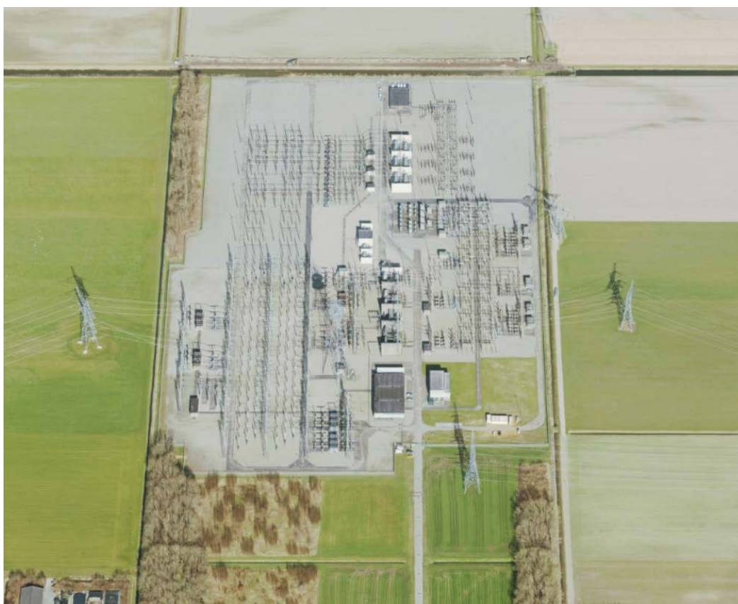
Figuur 5.1 Het bestaande hoogspanningsstation bij Ens
