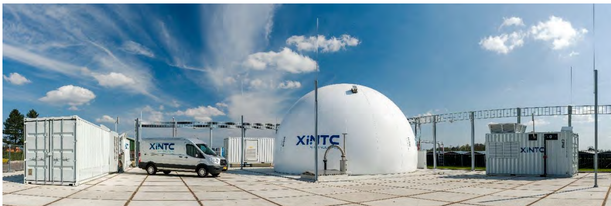
Foto: XINTC elektrolysesysteem inclusief tussenopslag en compressie-unit
