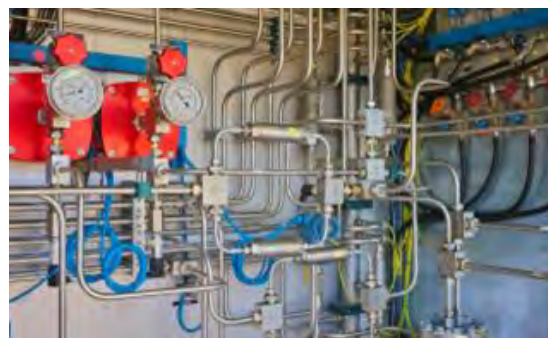
Foto: Detail compressieruimte
