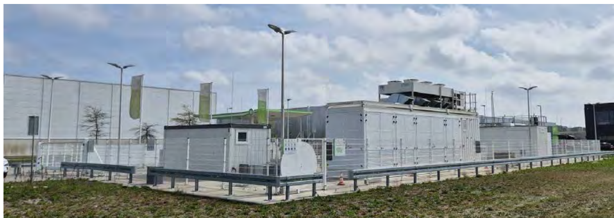
Foto: Installatie voor productie van hernieuwbare waterstof bij Holthausen Energy Points in Amsterdam
