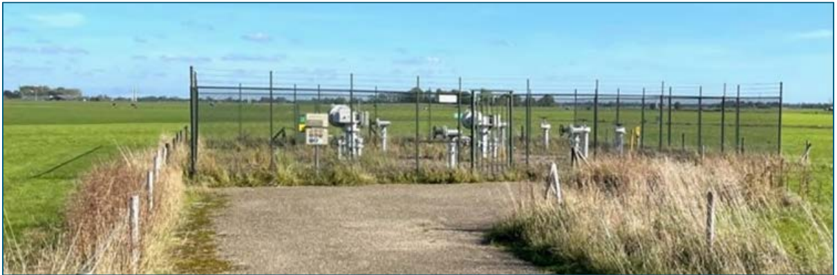
Figuur 3-5 Voorbeeld van een afsluiterlocatie van het aardgastransportnetwerk (bron: Gasunie).
