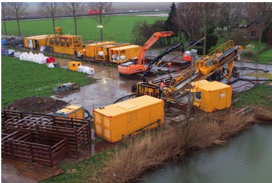
Figuur 3-3. Boorstelling voor de uitvoering van een horizontaal gestuurde boring (bron: Gasunie).
