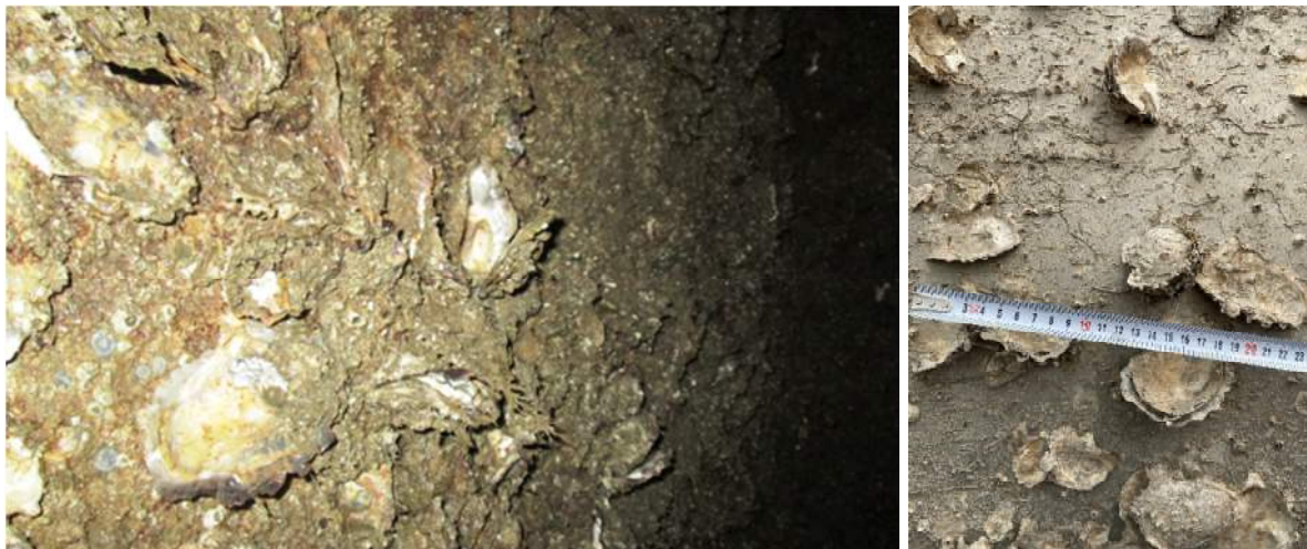
Figuur 3. Aangroei van de Japanse oester: links op betonnen wand van een koelwaterkanaal; rechts op stalen schacht van een koelwaterpomp (foto credits: Pecten Aquatic).
