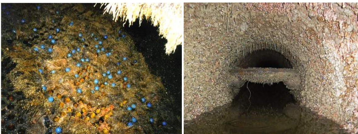
Figuur 1. Voorbeelden van biologische aangroei in een doorstroom koelwatersystemen: links, hydroïden op een condensor pijlplaat met ingevangen sponsrubberballen; rechts, aangroei in een koelwaterleiding en vlinderklep (foto credits: H.A. Jenner).
