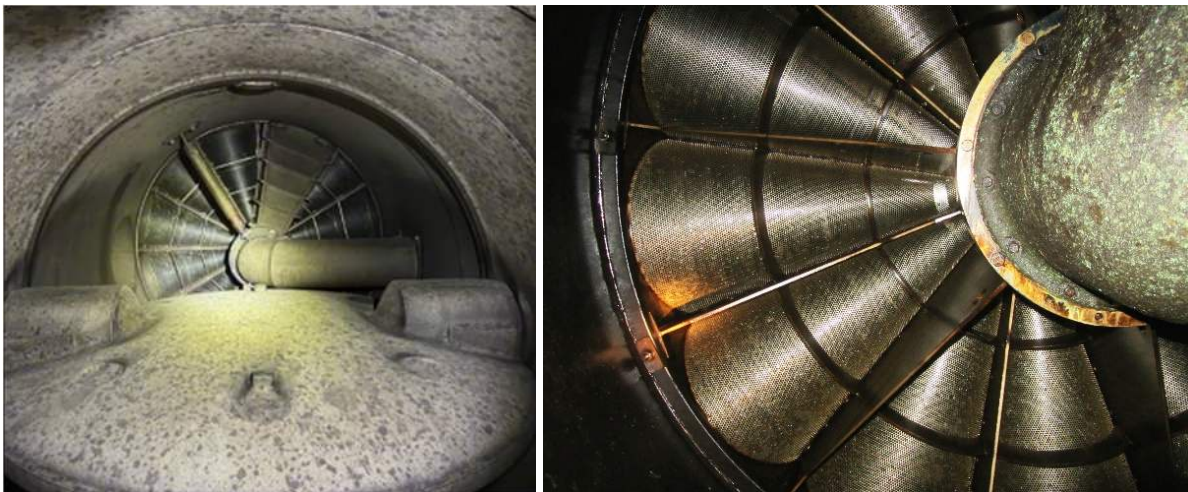
Figuur 5. Zelfreinigende debrisisfilter ('mosselzeven') links vooraanzicht met vacuümsysteem om afgevangen materiaal te verwijderen en de vlinderklep om het filter te kunnen isoleren, rechts de achterzijde met aandrijfmechanisme (foto credits: M. Holierhoek).
