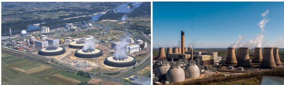
Figuur 5. Voorbeeld van het ruimtegebruik: links koeltorens met mechanische trek (30 m hoog) van EDF Chinon B kerncentrale in Frankrijk (bron foto: World Nuclear Association website), rechts koeltorens met natuurlijke trek, Drax energiecentrale in de UK (bron foto: Drax website).
