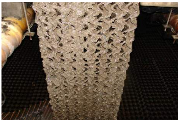
Figuur 6. Voorbeeld van slibafzetting in een koeltorenpakket (Maulbetsch & DiFilippo, 2008 ppt).
