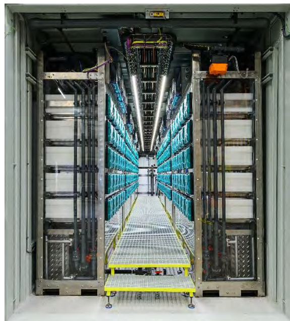
Foto: Modulair opgebouwde elektrolyser XINTC
