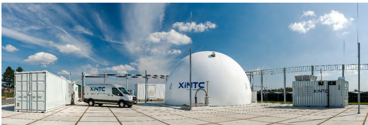
Foto: XINTC elektrolysesysteem inclusief tussenopslag en compressie-unit
