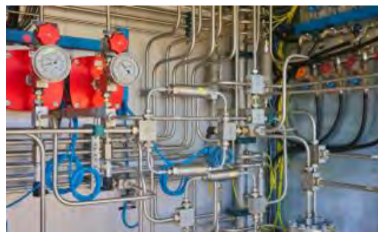
Foto: Detail compressieruimte
