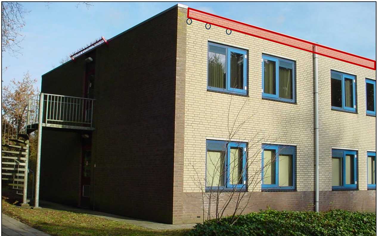
Figuur 5.3 Overzichtsfoto gebouw 25, in rood de locatie van de gevelbetimmering aangegeven. Enkele open stootvoegen omrand, hier dient ten minste één stenenrij afstand van gehouden te worden.
