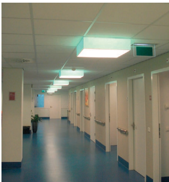
Voorbeeld van energie-efficiënte verlichting: gang verlicht met opalen opbouwarmatuur in energie-efficiënte uitvoering (3 x 14 W).
