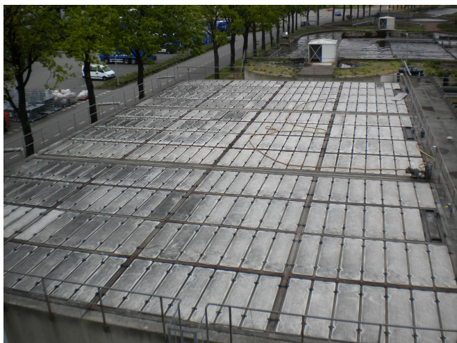
Bovenaanzicht van de de anaërobe zuiveringsreactor
