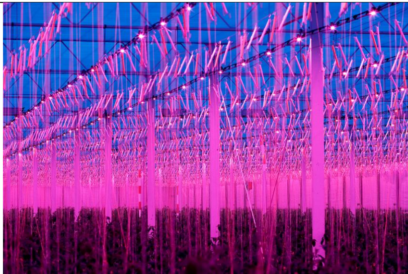
Figuur 1: Impressie van een praktijk installatie met leds.
